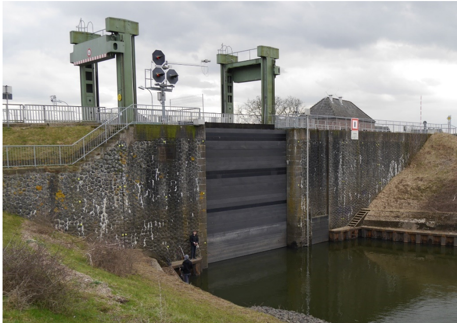
Schleusenunterhaupt mit gesetzten Dammbalken
