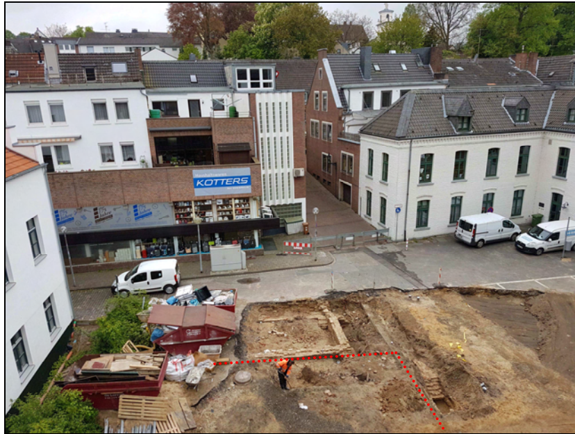
Abbildung 4: Befunde West- und Nordkreuzgangflügel während der Freilegung. Rot markiert die Rekonstruktion der Innenkanten des Kreuzganges. (Quelle: WAB 2017)
