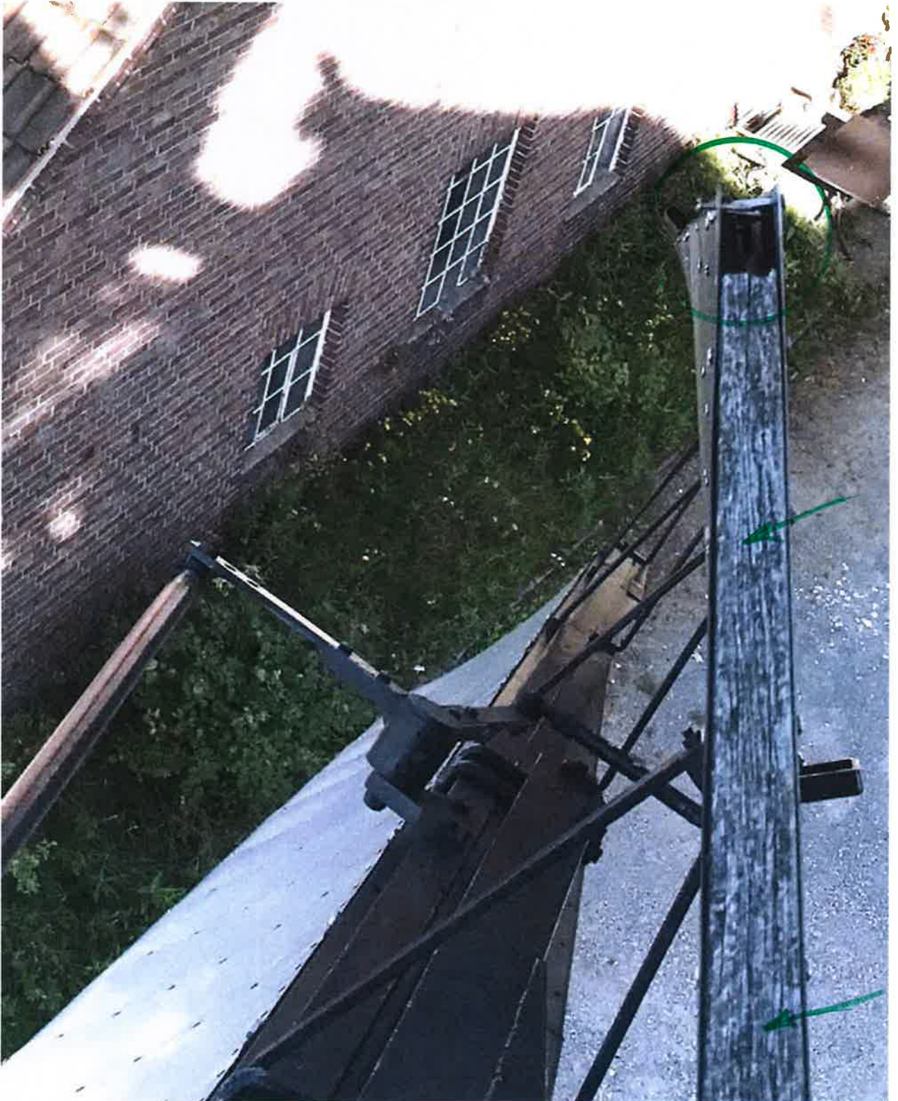
Schadhafte Holzkanten an einer sog. „Ventibremse“ des bilauschen Ventikantenflügels
