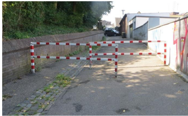
Abbildung 26: Schmale Umlaufsperrre, zugleich erschütterungsreiche Muldenrinne im Laufbereich (Schlossstorstraße)
